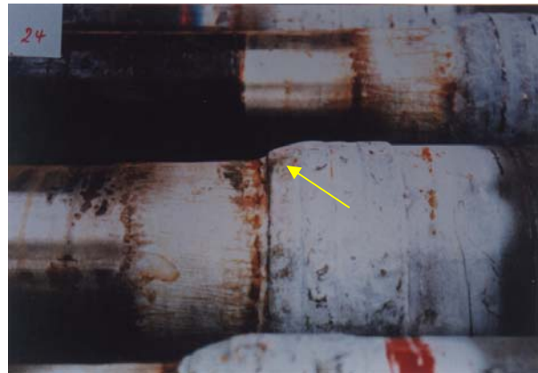
不合格的斜坡焊道
