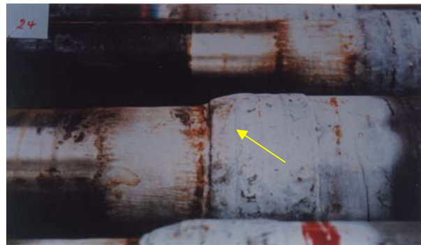
不合格的斜坡焊道
