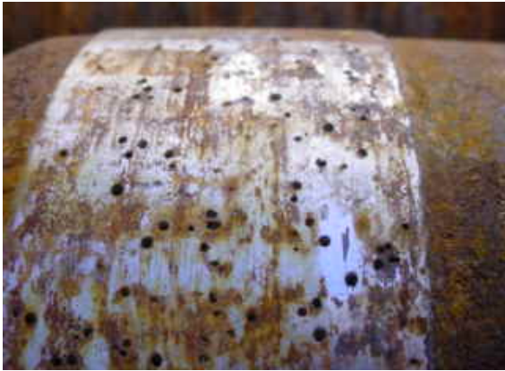
过多气孔，已磨损但仍完整
